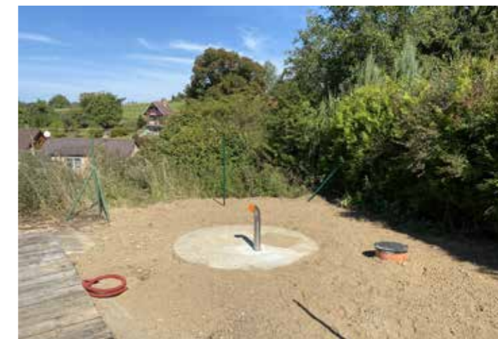
Odkalovací nádrž k ČOV 50 EO Pod Lesem
